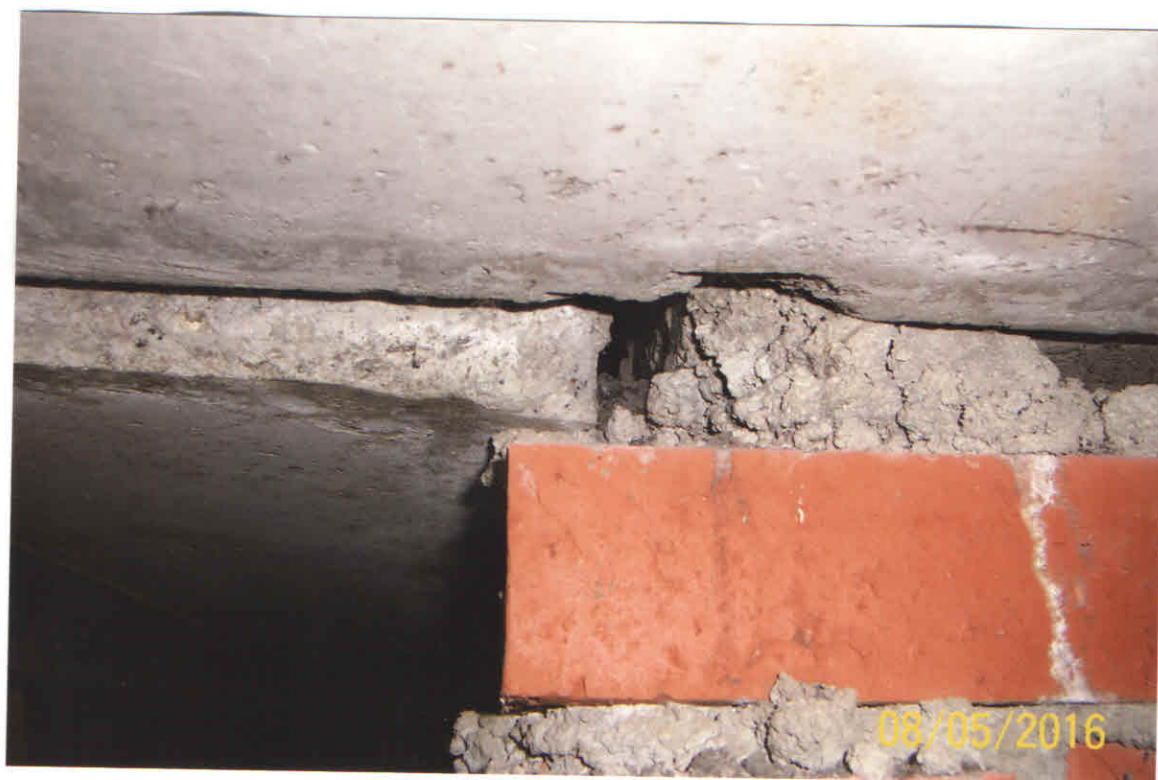
Фото 22. Применение пустотелого кирпича вместо полнотелого в месте опирания плит покрытия
