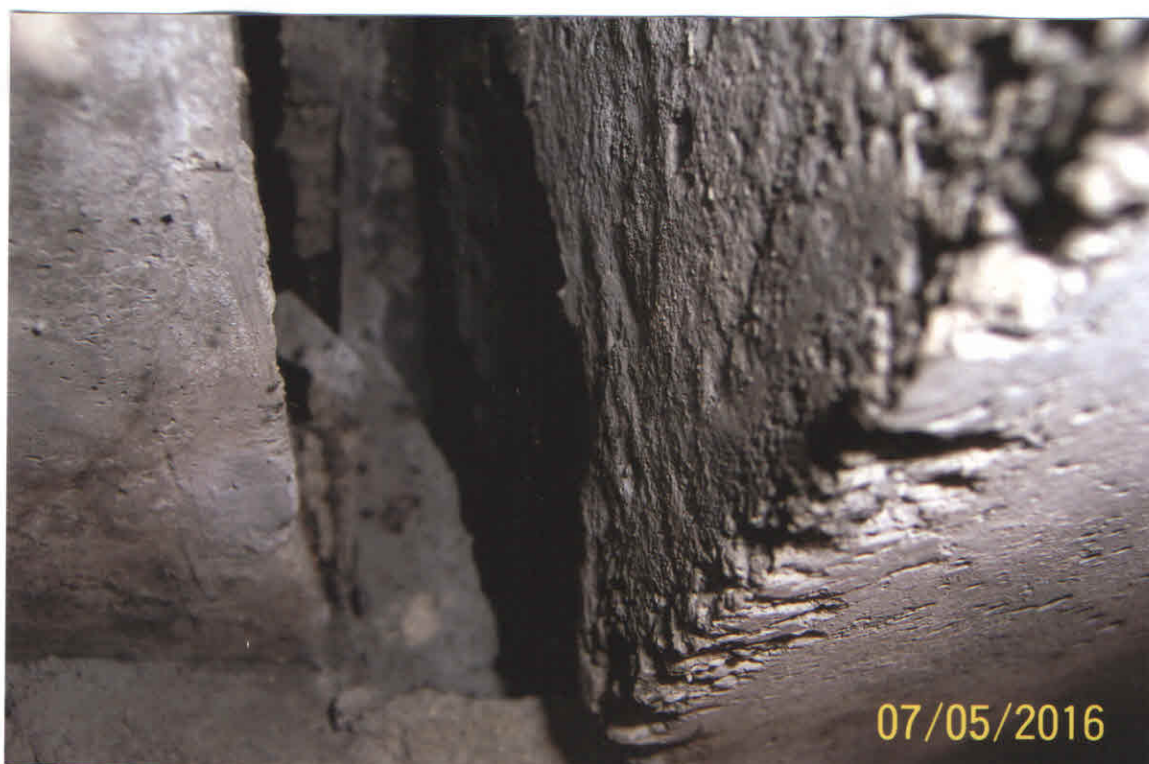
Фото 20. Сколовшийся защитный слой бетона торца плиты покрытия
