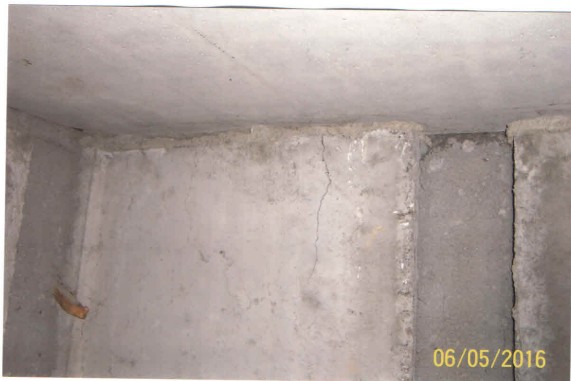
Фото 6. Трещины на парапетном блоке по оси Гс у оси 1
