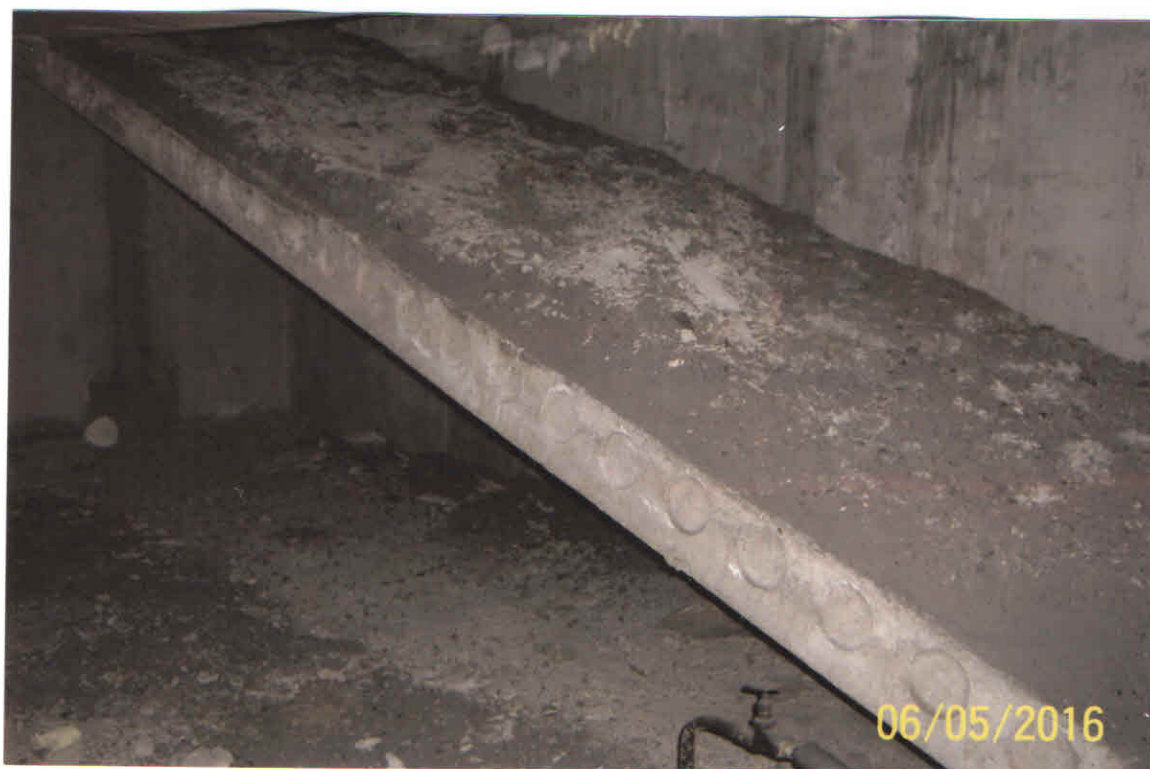
Фото 12. Обрушившаяся плита покрытия вдоль оси 1 в осях Ас – Вс
