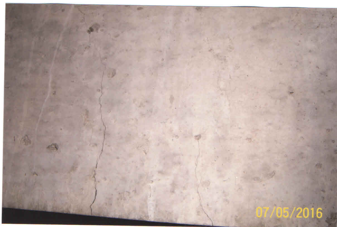
Фото 27. Трещины в балке покрытия
