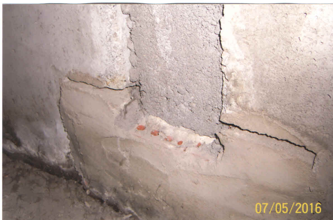
Фото 9. Зазоры между кирпичными заделками и парапетными блоками по оси Ас
