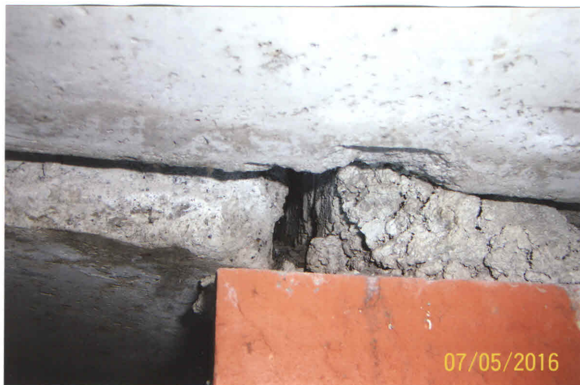
Фото 19. Смещение плиты покрытия по оси Вс в сторону оси Ас 30 мм
