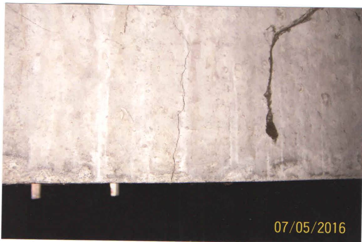
Фото 28. Трещины в балке покрытия
