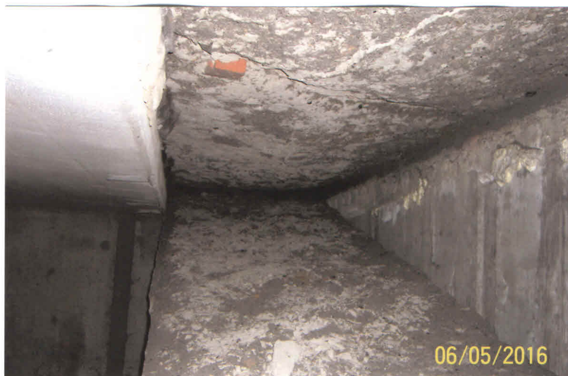
Фото 13. Обрушившаяся плита покрытия вдоль оси 1 в осях Ас – Вс
