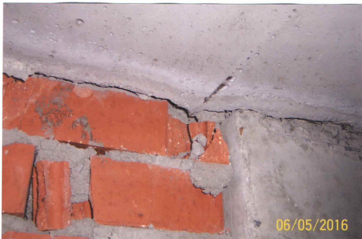
Фото 18. Разрушившийся торец плиты покрытия, опирание 5 мм
