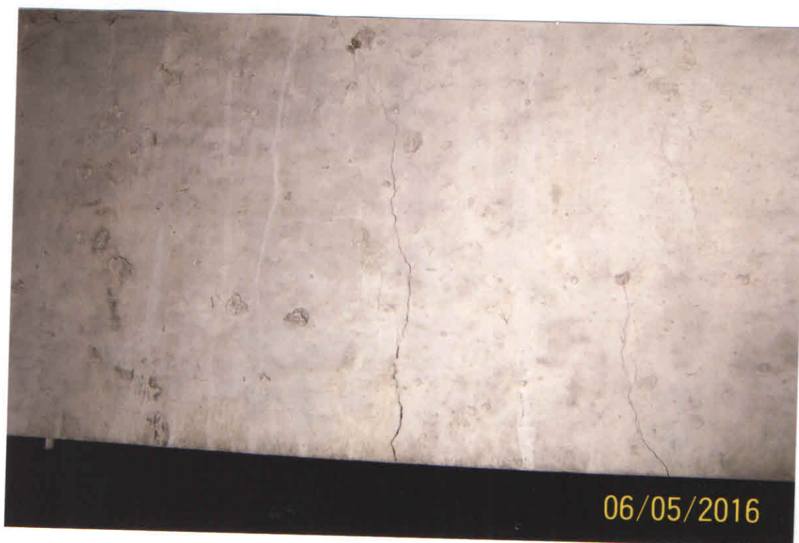
Фото 25. Трещины в балке покрытия
