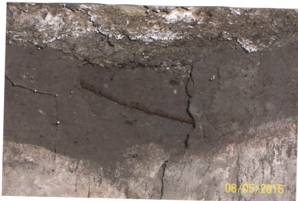
Фото 17. Сгнивший анкер между парапетным блоком и внутренней стеной по оси Вс
