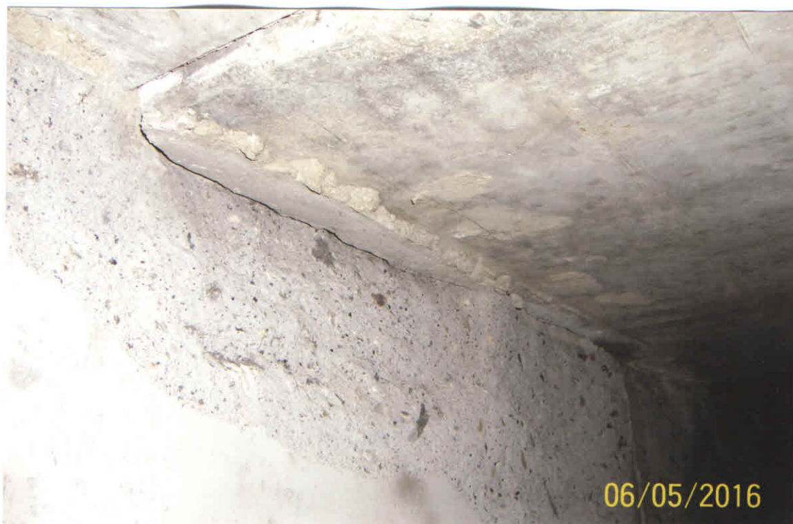
Фото 8. Сколы опорных частей парапетных блоков под плитами покрытия по оси Гс
