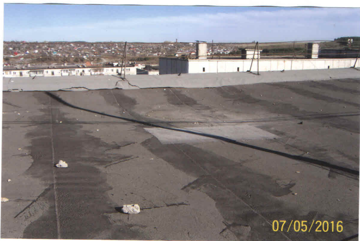
Фото 29. Провал кровли в месте обрушения плит покрытия
