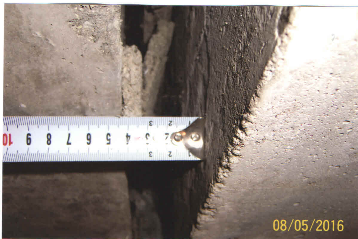
Фото 21. Смещение плиты покрытия по оси Вс в сторону оси Ас 30 мм
