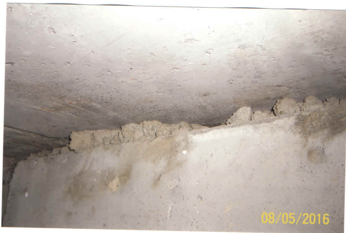
Фото 23. Не качественное устройство растворной постели под плитой покрытия
