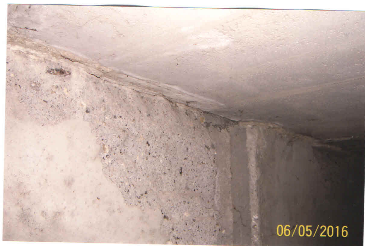
Фото 7. Сколы опорных частей парапетных блоков под плитами покрытия по оси Гс
